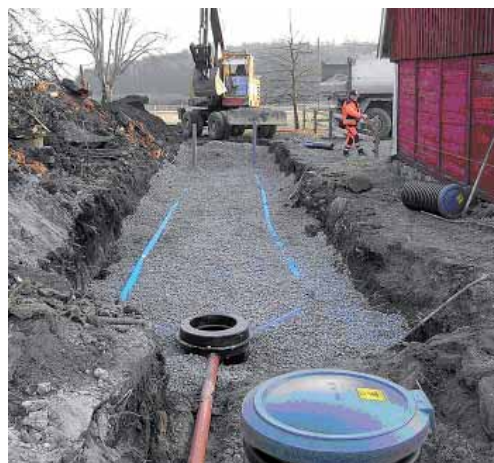
Enskild infiltrationsanläggning för avloppsrening.
