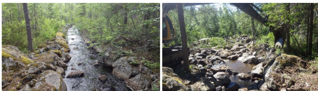
Figur 3.8: Restaurering av ett flottledsrensat vattendrag, här Kalvsån. Till vänster visas ett utträtat vattendrag anpassat till flottningen av timmer, och till höger visas samma vattendrag under pågående restaurering, foto Peter Hallgren, Fiskevårdstjänst.
